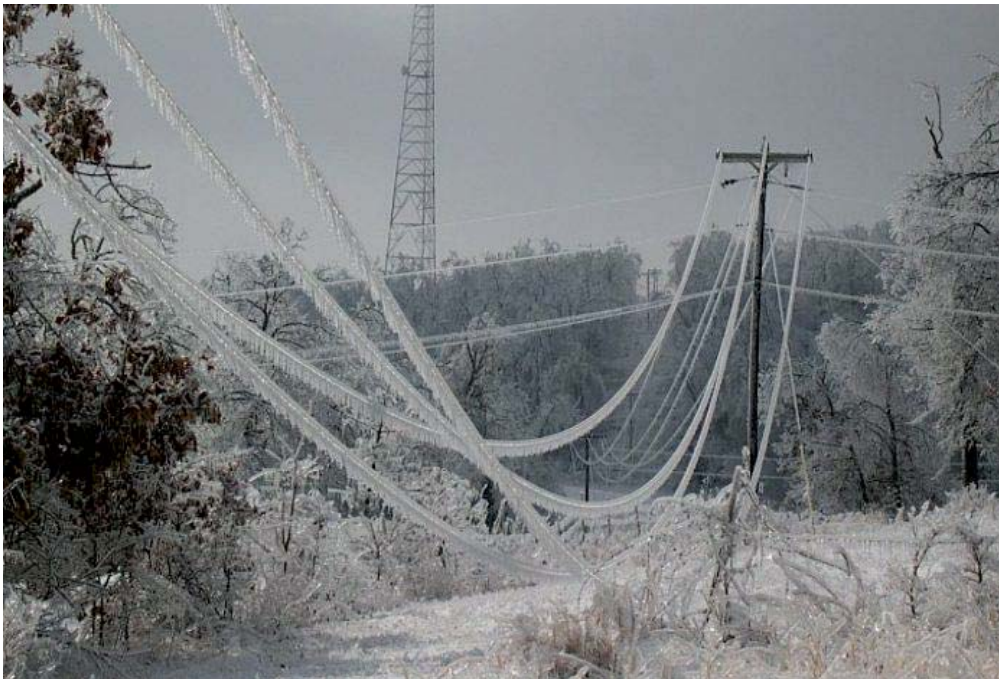
Zaleđen provodnik na nadzemnom vodu 0,4 kV
